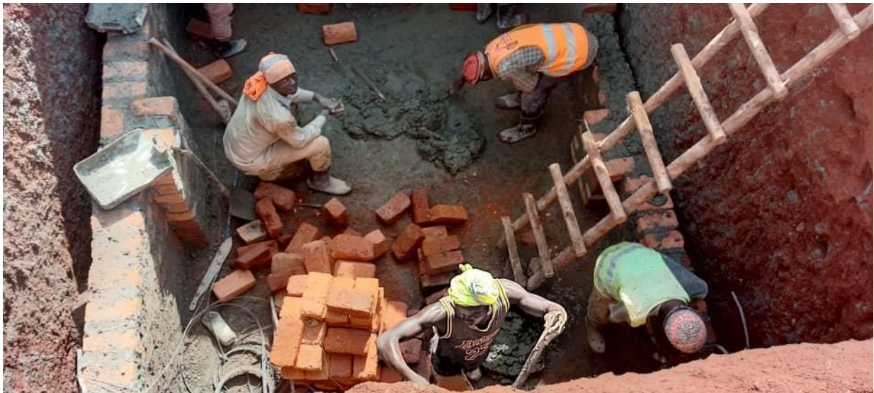
De septic tank voor de extra buiten latrines
